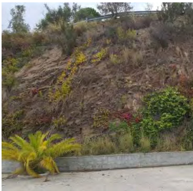
Figura 9 – Affioramento di gneiss con porzioni fratturate, alterate e disarticolate
