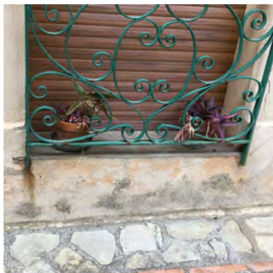
Umidità di risalita
