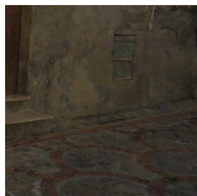
Umidità di risalita
