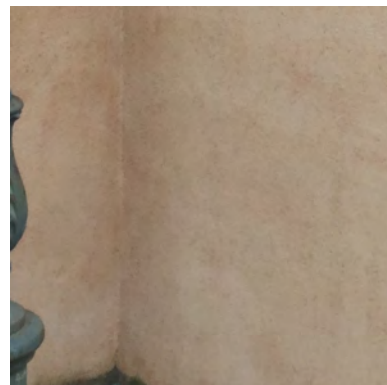
Umidità di risalita
