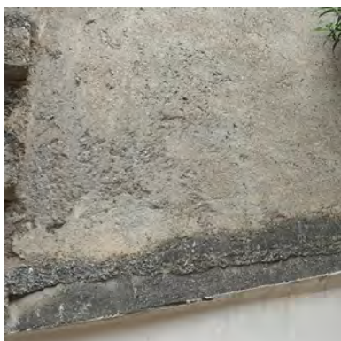
Umidità di risalita
