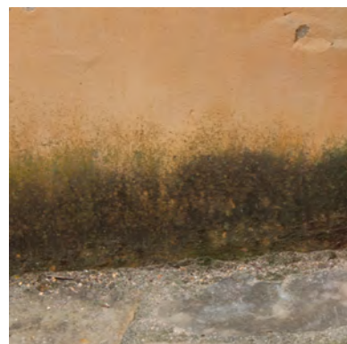
Umidità di risalita
