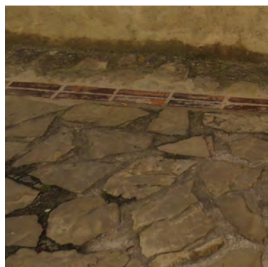
Umidità di risalita
