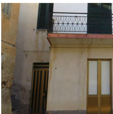
Umidità di risalita
