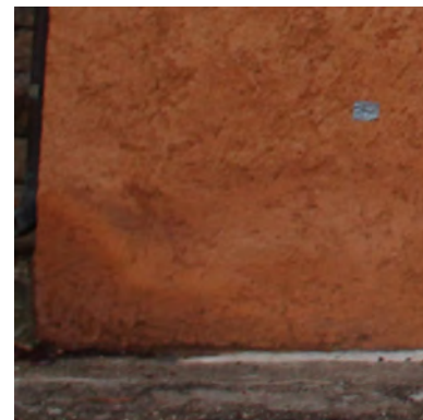
Umidità di risalita
