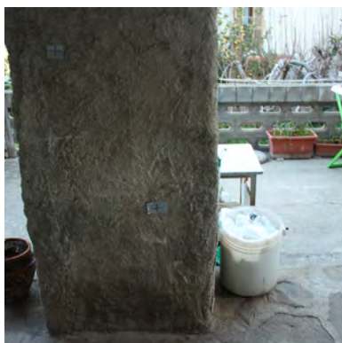
Umidità di risalita
