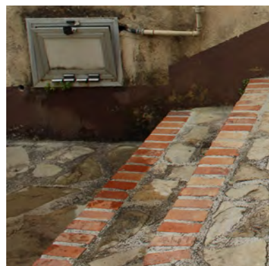
Umidità di risalita
