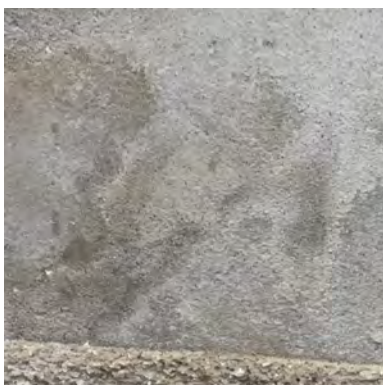
Umidità di risalita
