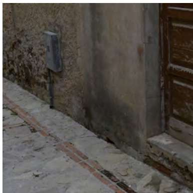
Umidità di risalita
