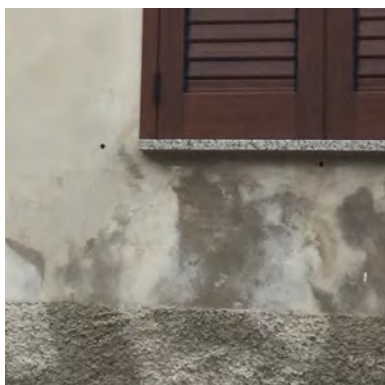
Umidità di risalita
