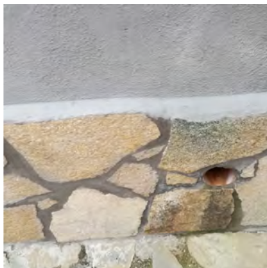
Umidità di risalita
