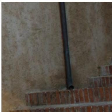
Umidità di risalita
