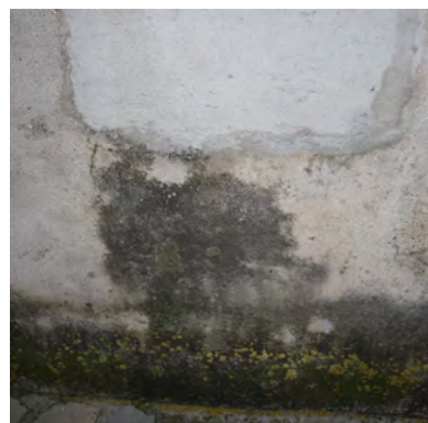
Umidità di risalita
