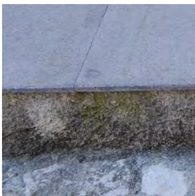
Umidità di risalita
