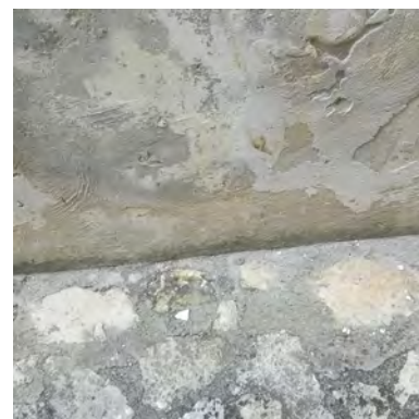
Umidità di risalita
