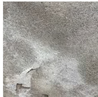
Umidità di risalita
