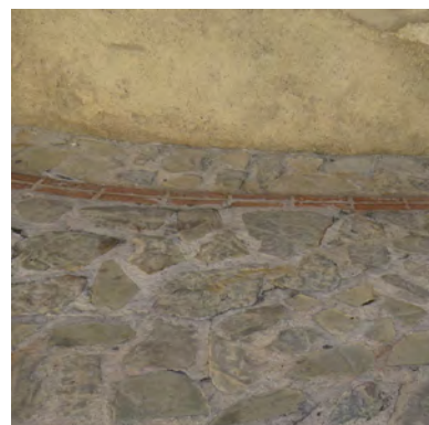
Umidità di risalita
