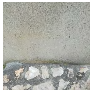
Umidità di risalita
