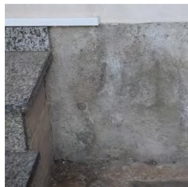
Umidità di risalita
