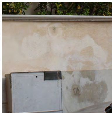
Umidità di risalita
