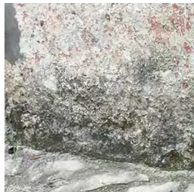
Umidità di risalita
