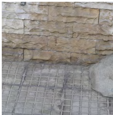
Umidità di risalita
