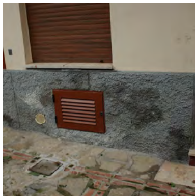
Umidità di risalita
