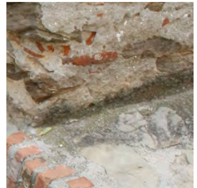
Umidità di risalita
