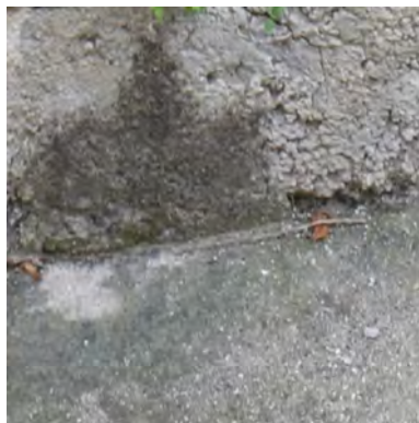
Umidità di risalita
